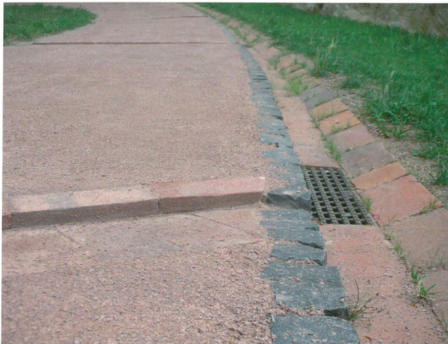
7 Querrinnen, hier als Aufkantung, können Wasser effektiv abführen. Sauberhaltung ist wichtig.
